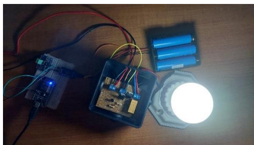
b. Rangkaian Kontrol PJUTS dan sistem monitoring
