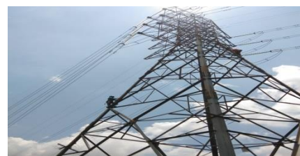
Gambar 1. Saluran Udara Tegangan Tinggi
