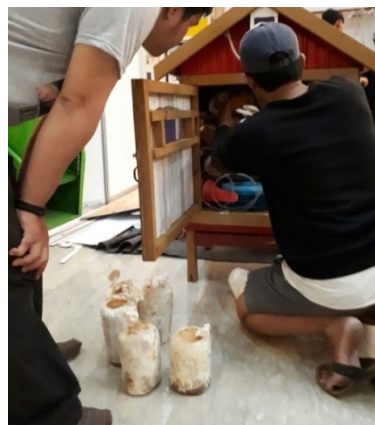
Gambar 4. Proses Instalasi Unit Integrated Device Electronic pada kumbung mini
