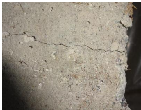
Gambar 3. Gambar pola retak pada balok
