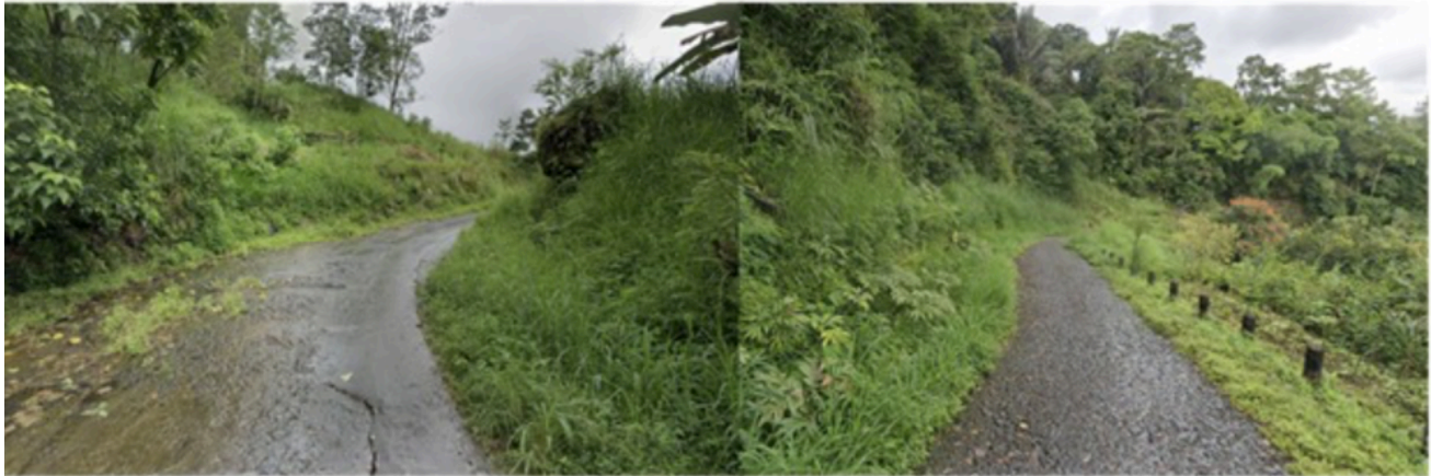
Gambar 1. Kondisi jalan desa dengan lereng rawan longsor
