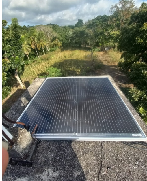
Gambar 6. PV yang Terpasang di Atap Rumah Kebun
