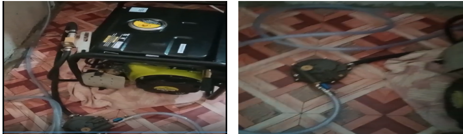
Gambar 3. Penyambungan Genset dengan Saluran Biogas
