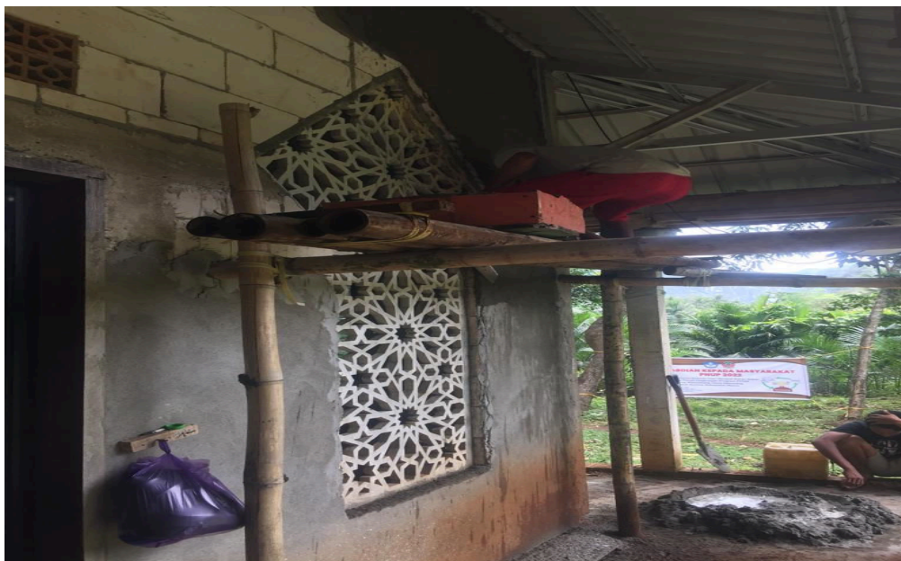
Gambar 2. Kondisi sebelum dilaksanakan pengecatan
