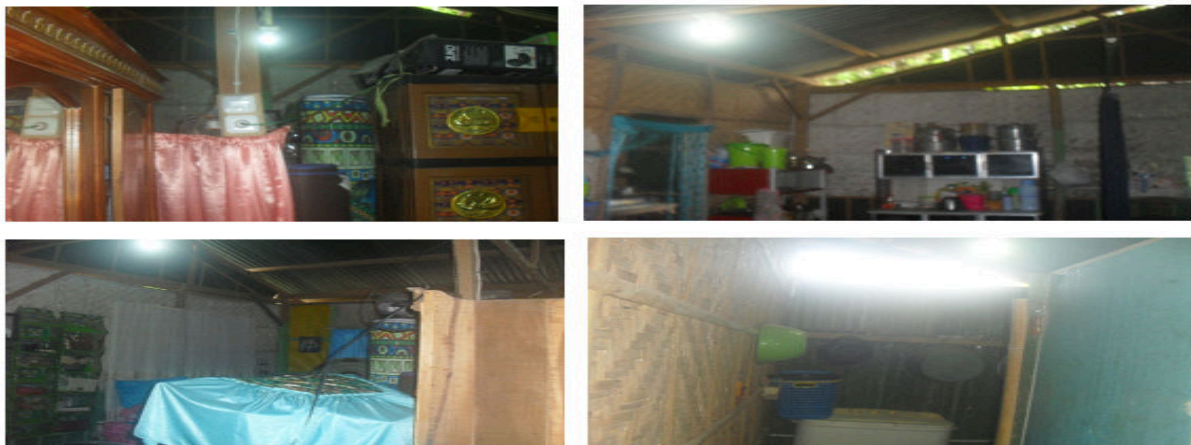
Gambar 4. Pengoperasian Instalasi Listrik Penerangan
