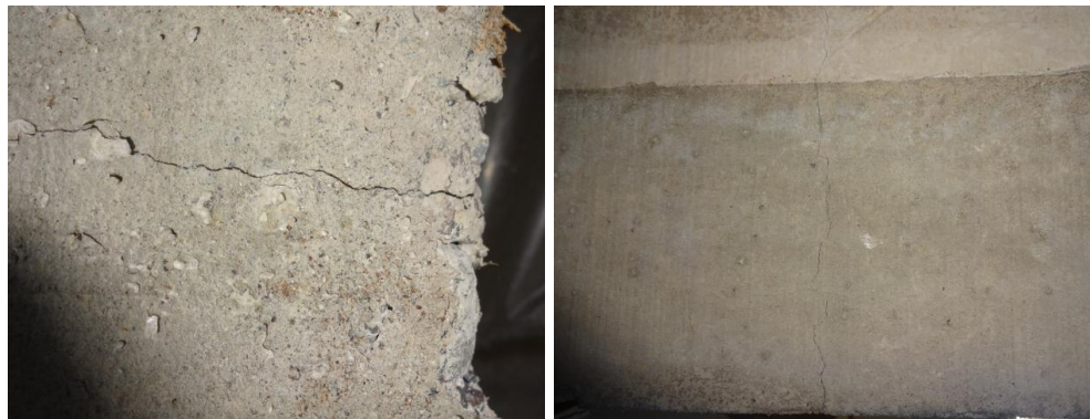
Gambar 3. Gambar pola retak pada balok
