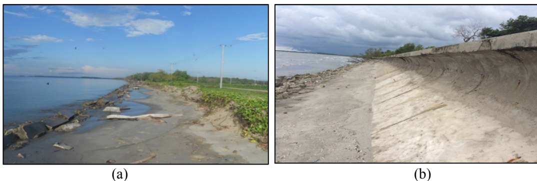
Gambar 1. Kondisi Pantai Wisata Mampie : (a) abrasi dan kegagalan struktur seawall (dokumentasi pra konstruksi tahun 2013, rekonstruksi dilakukan pada tahun 2014), (b) Hasil rekonstruksi bangunan seawall (dokumentasi pasca konstruksi tahun 2016)
