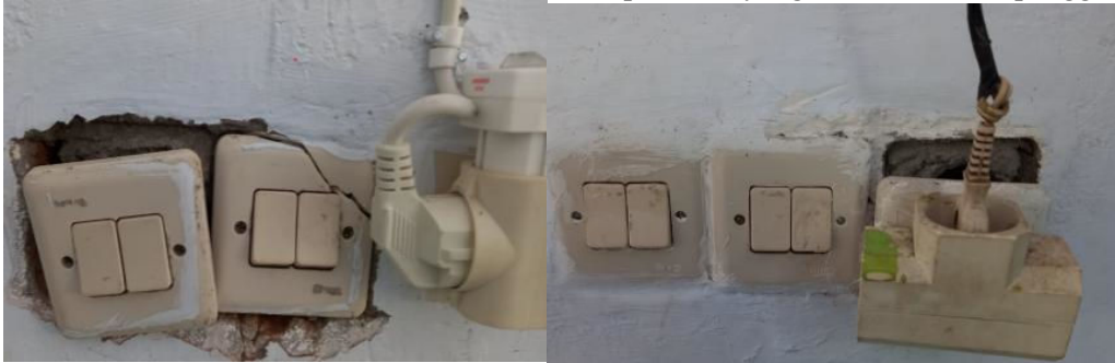
Gambar 1. Saklar dan Stop Kontak bermasalah
