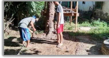
b) Kondisi setelah dibersihkan
