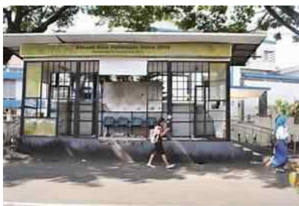
Shalter BRT Trans Kawanua yang telah rusak
