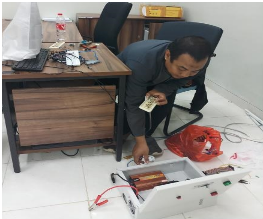
Gambar. 2 Perakitan Komponen Sistem Automasi Pada Panel Penjelasan dan Pelatihan Terhadap Mitra Terkait Penggunaan Sistem Automasi Listrik
