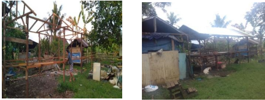
Gambar 1. Pembuatan rangka bangunan kandang Rangka bangunan kandang terdiri dari balok sisa dan balok baru yang dibuat dalam bentuk panggung dengan ukuran 2 x 8 meter
