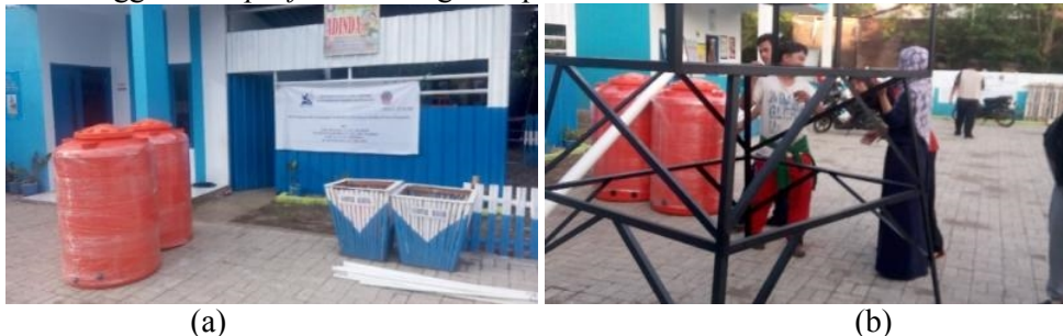
Gambar 1. (a) Profil tank untuk penampungan air dan pipa PVC untuk instalasi air, (b) Menara air rangka baja
