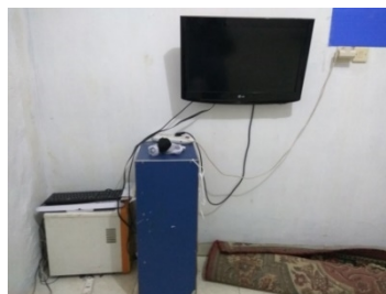
(a) Kondisi Instalasi Perangkat ultimedia sebelum kegiatan PKM
