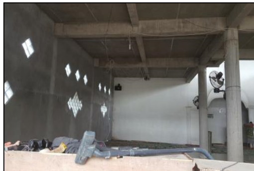
Gambar 2. Instalasi Listrik yang belum terpasang
