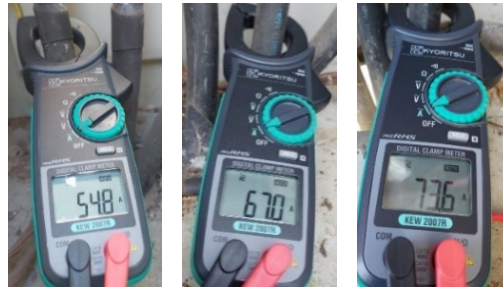
Gambar 2. Pengukuran 3 Phase Gardu GT.MTB 003
