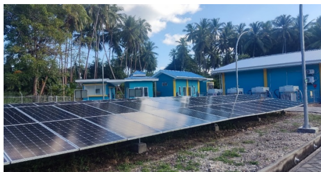
Gambar 3. String array modul surya PLTS Selayar
