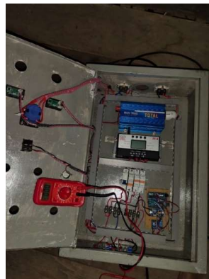
Gambar 4. Modul Instrument Pembangkit Listrik Hybrid Plts Genset.
