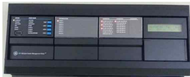
Gambar 4. Relay UR F35 untuk Proteksi Feeder 48-FDR-33 Sumber: PT Badak NGL
