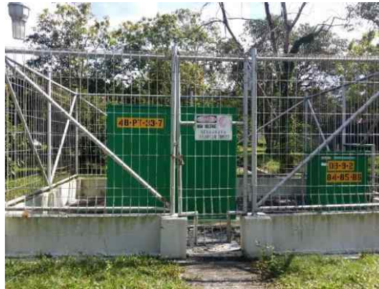
Gambar 2 Lokasi Trafo 48-PT-33-7 Sumber: PT Badak NGL
