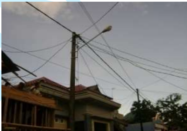
Gambar 6 . Prasarana kelistrikan di luar rumah
