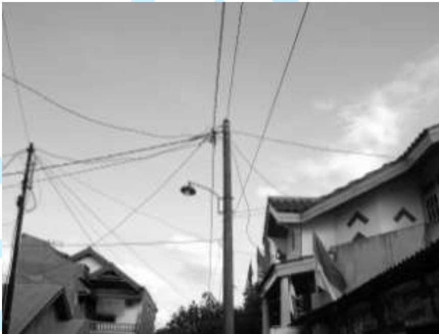
Gambar 8 . Kondisi beberapa prasarana kelistrikan diluar rumah pada permukiman BTP Kota Makassar
