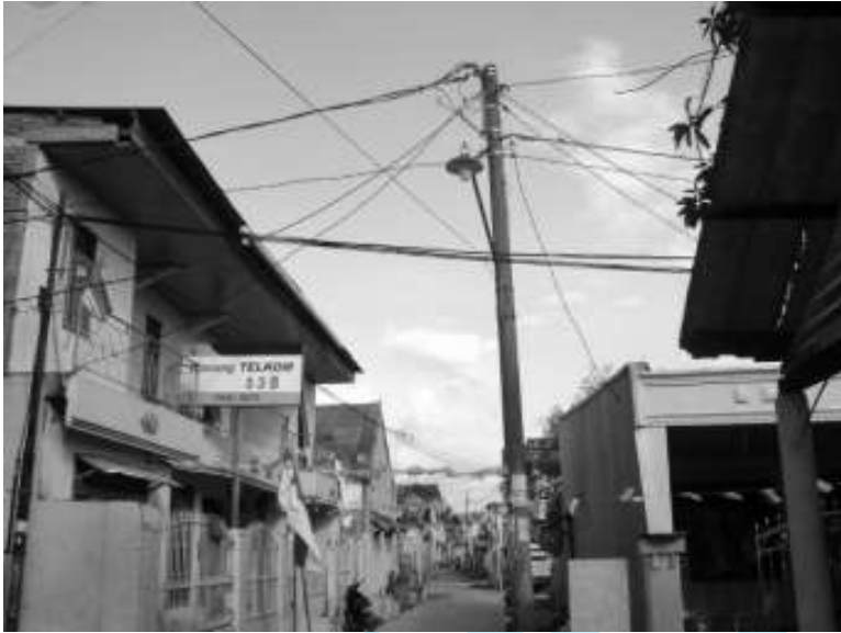
Gambar 7. Jaringan kabel distribusi tegangan rendah
