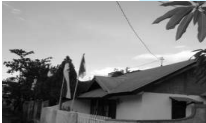
Gambar 5. Jaringan kabel distribusi sambungan Rumah 220V / 900VA
