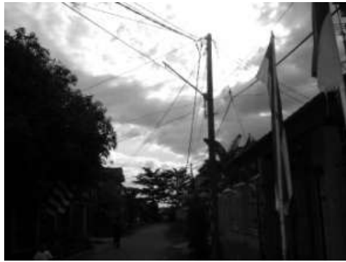
Gambar 4. Prasarana Kelistrikan di luar rumah
