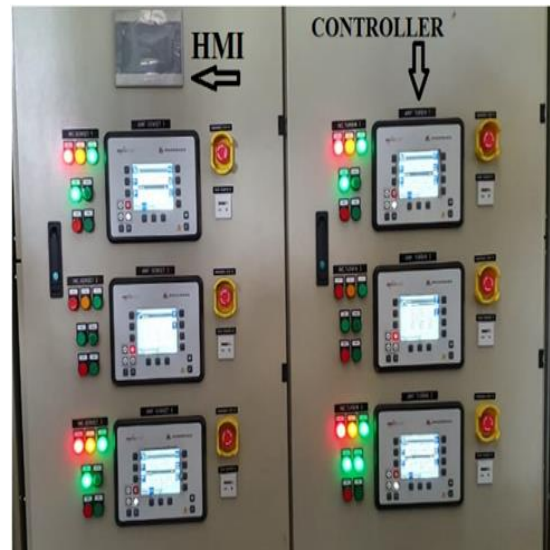
Gambar 8. Hasil Instalasi Panel Sinkronisasi Paralel Generator
