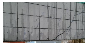
Gambar 14. Pola Retak Benda Uji Balok Beton Bertulang Variasi 2 B4 – GFRP+CFRP
