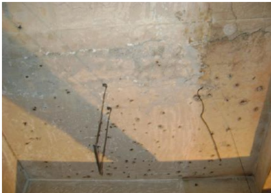
Gambar. 7. Kondisi pelat lantai 2 pasca kebakaran
