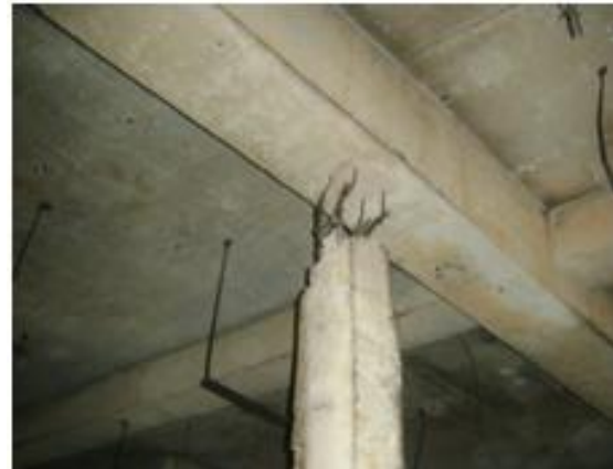
Gambar. 8. Kondisi balok dan kolom praktis lantai 1 pasca kebakaran
